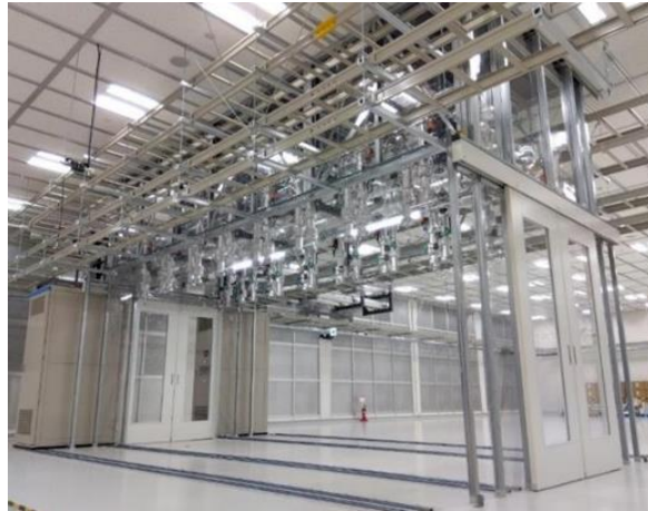
液冷導入可能なデータセンター内設備
