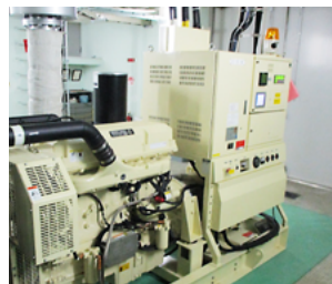
【局舎非常用発電装置】
