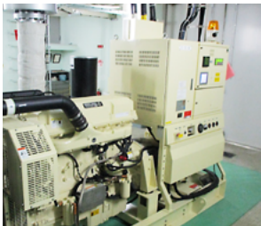
【局舎非常用発電装置】
