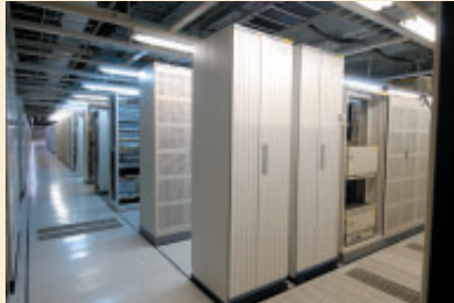
■通信機械室のラック群
