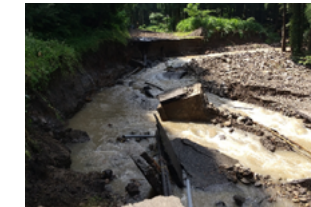
[ 福井～滋賀間の被災状況 ]
